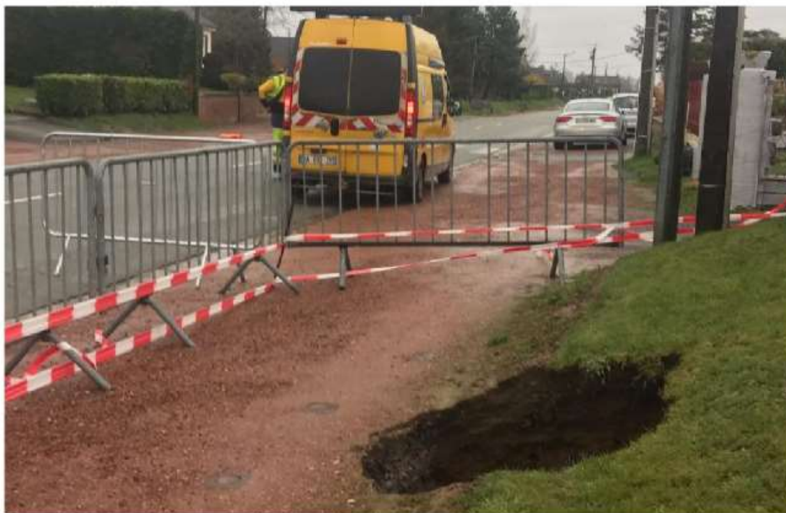
Depuis la mi-mars et l'effondrement de terrain, la route départementale est coupée à Rombies-et-Marchipont.
